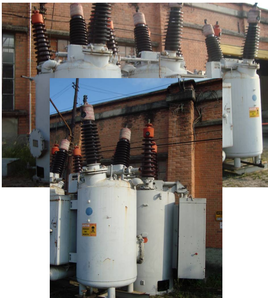
Disjuntor (grande volume de óleo)
